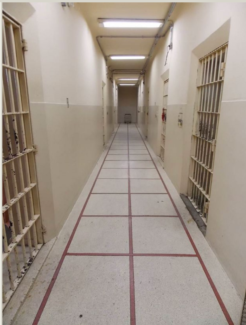
Figura 5 - Corredor de acesso às celas do primeiro pavimento do DOPS. Fonte: Dossiê de Tombamento. Departamento do Patrimônio Cultural de Belo Horizonte
